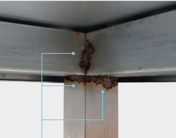
Oxidación por soldadura
