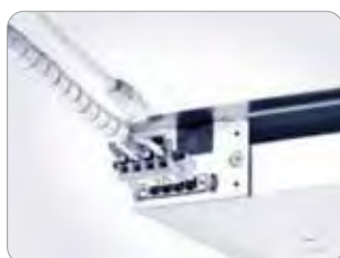
Conexión enchufe generador
