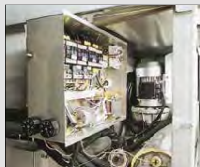
Cuadro eléctrico LP-67
